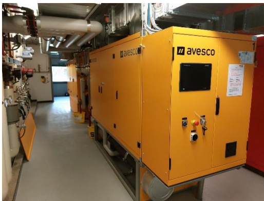
BHKW fertig montiert
