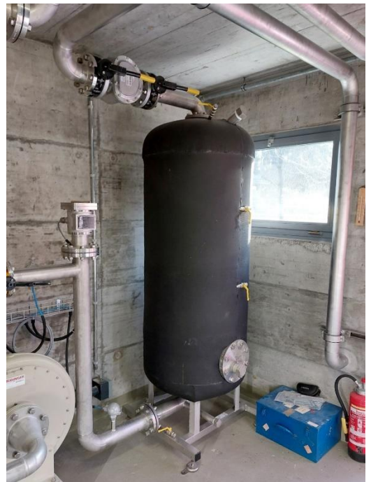
Aktivkohlefilter mit Gaserwärmung
