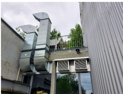
Zu- und Abluft BHKW
