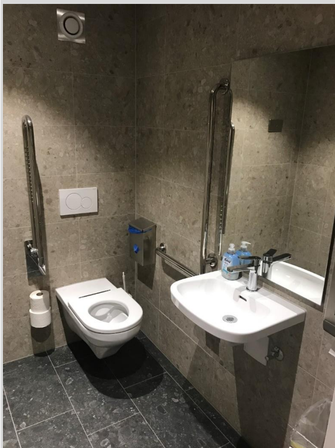
Neue IV WC Anlage
