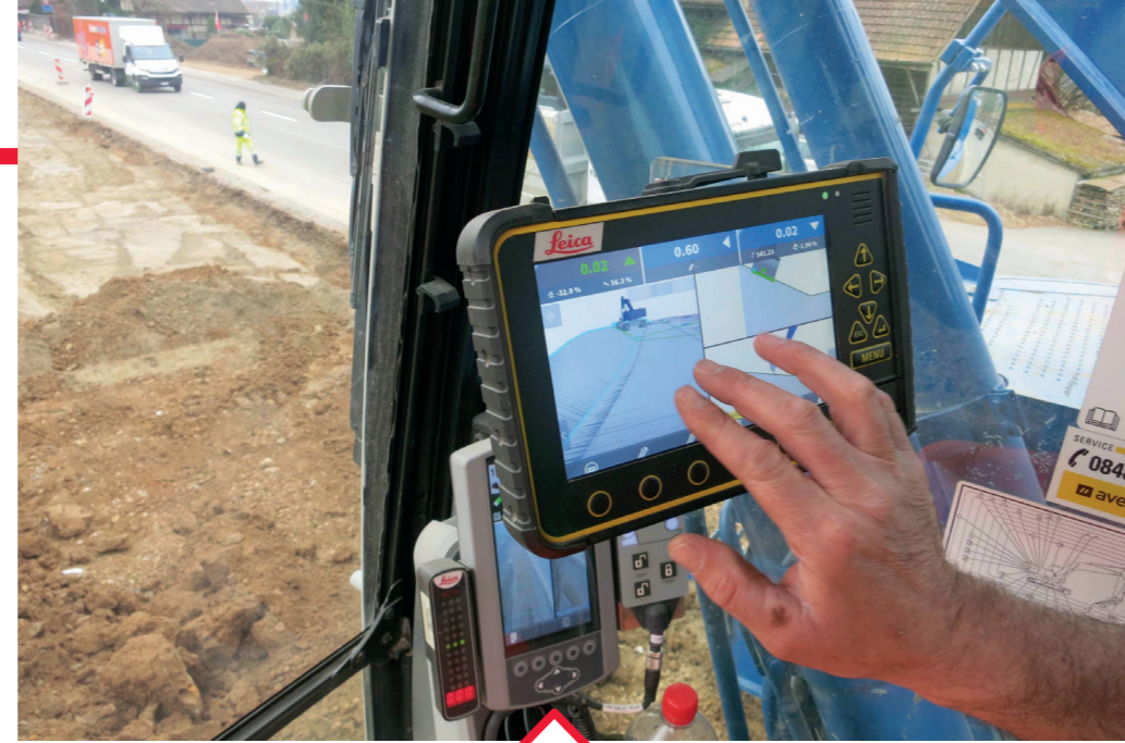
Präzisionsarbeit: Ein GPS-gesteuerter Bagger trägt bei der Ortseinfahrt Nord die Böschung ab.
