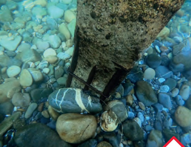
Beschädigungen am Fundament der Schützenfahrbrücke Münsingen
