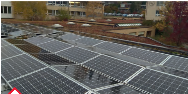
Die JZZ-Anlage hat im vergangenen Jahr 18 000 kWh Solarstrom produziert.
