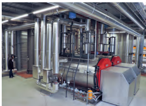
Energiezentrale Süd – Innenansicht
