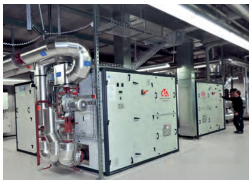
Wärmepumpen Heizzentrale Nord
