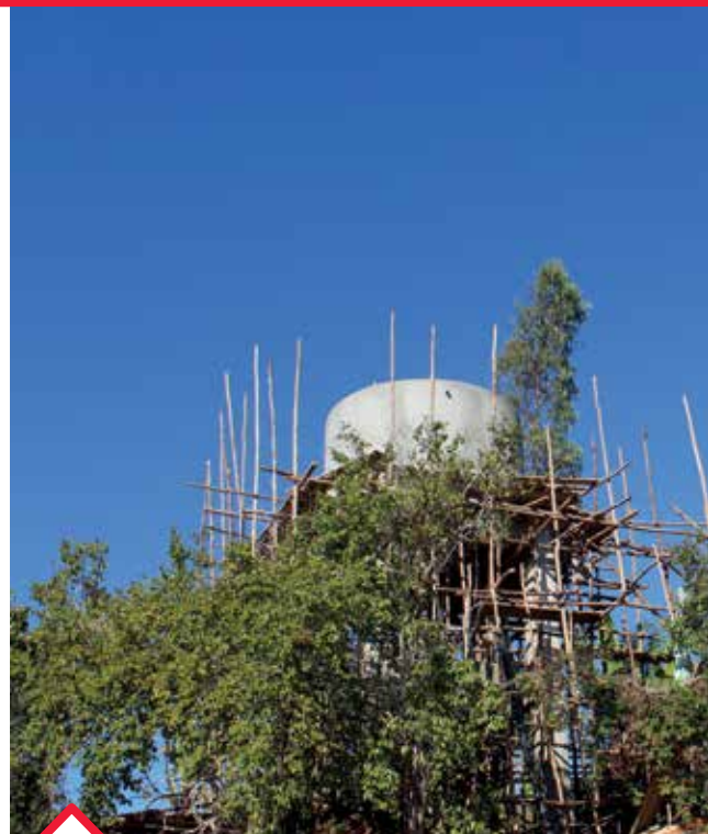
Das Wasserreservoir im Dorf Mangabe enthält einen Schwimmer, der den Wasserstand misst. Foto: Helvetas Madagaskar.
