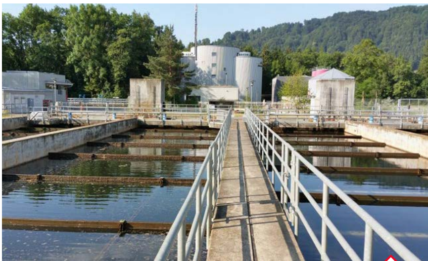
Klärbecken der ARA Region Münsingen
